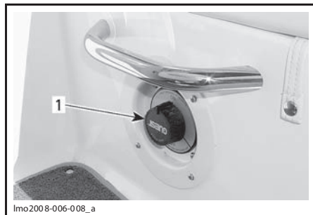
1. Выключатель электропитания от аккумуляторной батареи
