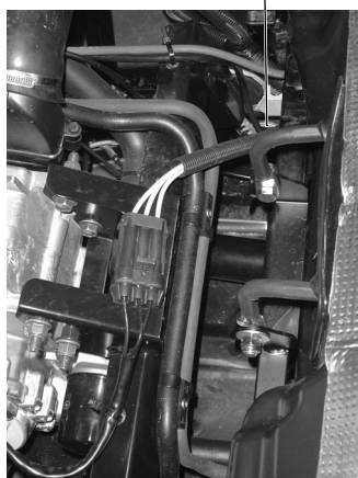
Блок силовых предохранителей
